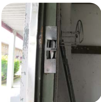
Dårlig aflåsning, har gjort det muligt at tage ophold i redskabsrum
