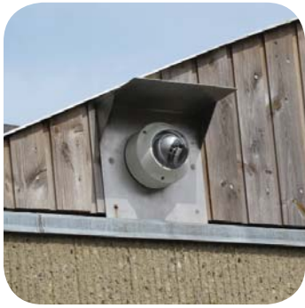
Et domekamera monteret på gavl
