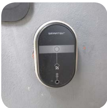
Onlinelæser monteret udendørs
