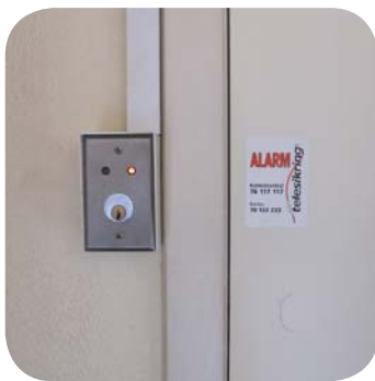
Til- og frakobling af alarmsystemet
